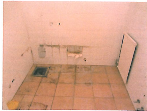
De som passade på att renovera sina badrum på egen bekostnad fick allt upprivet så att föreningen kunde byta sina rör under golvet.
